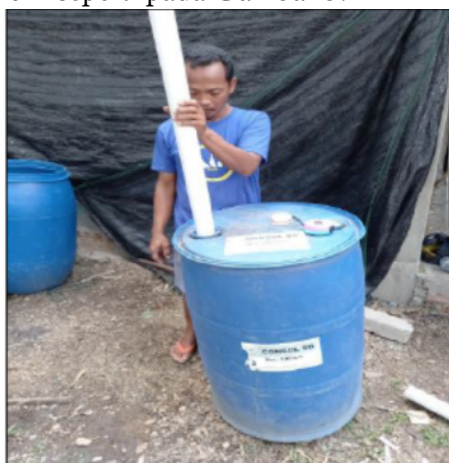
Gambar 3 Instalasi reaktor biogas
