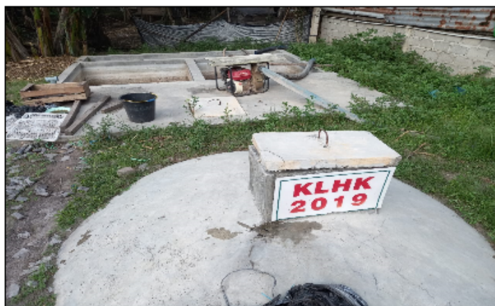
Gambar 1. Instalasi reaktor biogas bantuan KLHK Tahun 2019
